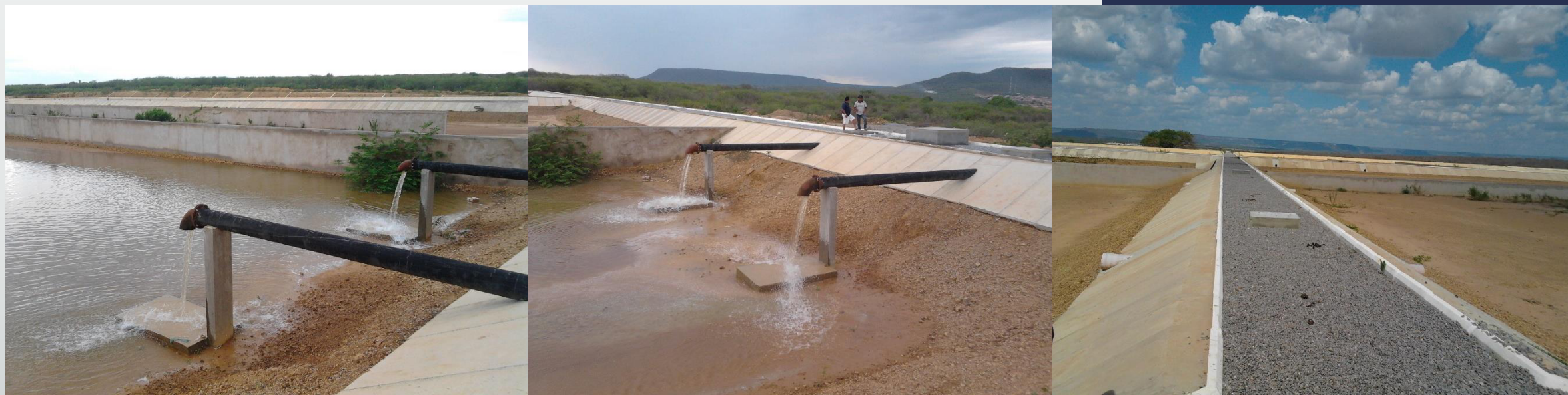
Lagoa de Estabilização em Ipubi/PE
