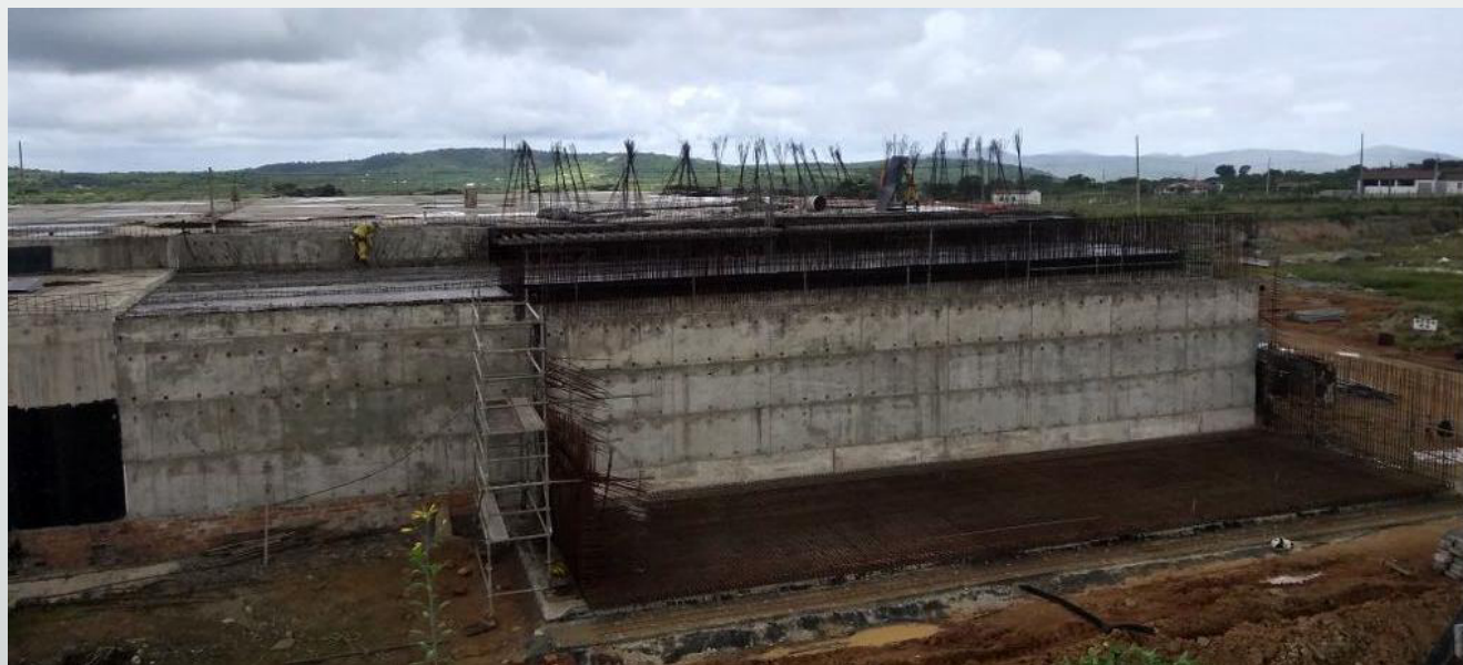
Estação de Tratamento de Água
