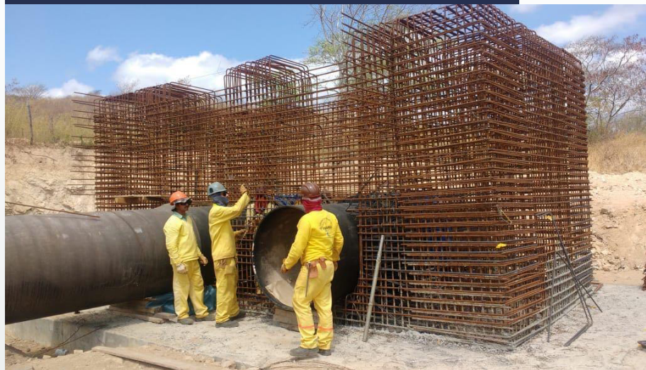
Bloco de ancoragem e caixa de manobra
